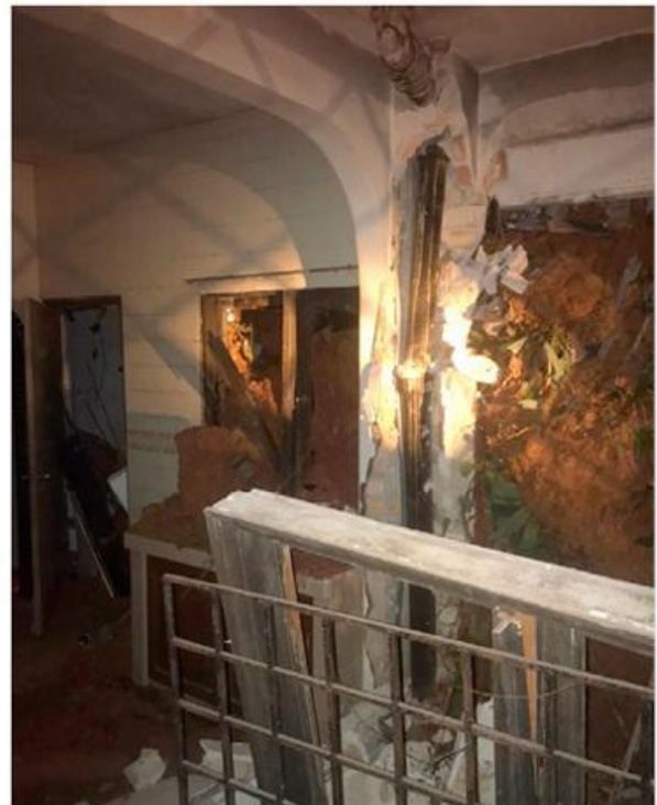
Keadaan kejadian tanah runtuh di sebuah rumah banglo di Taman Taman Halaman, Ampang pada Selasa.
